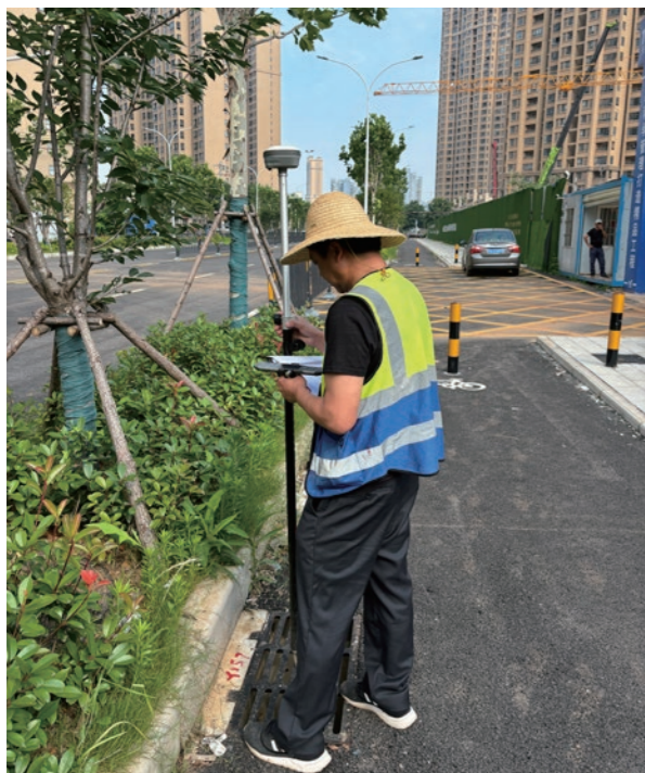
武汉市蔡甸区排水管网精细化排查项目部成员正在收测管线点
